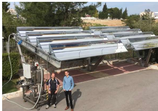
Solfångaren Absolicon T160 installerad i Aten. På bilden Mikael Ekman och Jonatan Mossegård från Absolicon.
