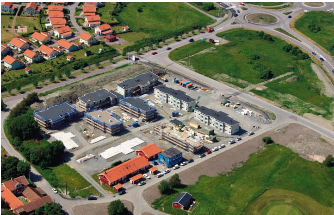
Här pågår nybyggnation av 70 bostadsrätter i Brf. Flygledaren. I juni månad kvarstår endast två hus att resa av samtliga 10 hus.
